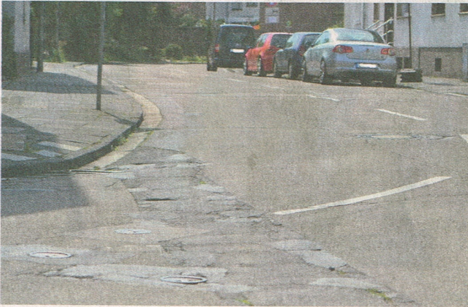
Die Mängel sind offensichtlich und wurden in jüngster Zeit punktuell ausgebessert. Foto: Göllnitz
